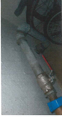
Billede: Eksisterende brugsvandsinstallation i galvaniseret jernrør med begyndende tæring
