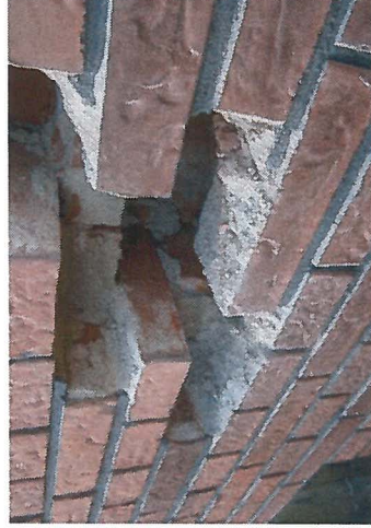
Billedet: Billede af undersøgelse af murværk på Sundby-Hvorup Boligselskab afd. 7. Engparten, som består af samme bygningstype som afd. 3. Der forventes derfor samme type murværk her. Som det ses er muren stort set massiv med store kuldebroproblematikker til følge.
