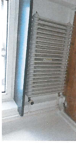
Billede: Eksisterende radiator
