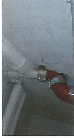
Billede: billede af repareret faldstamme efter rustangreb
